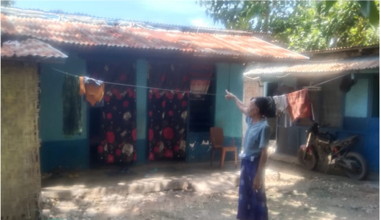
Rumah Ahmad Wila Pensiunan IKPLN Cabang Sumba sebelum diperbaiki.
